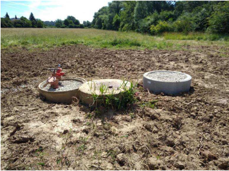
Figure 11 : Borne d'irrigation agricole, regard de sectionnement et buse avec vanne de vidange
